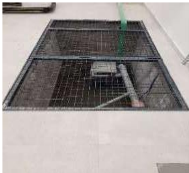
Slika br.8c, Bazeni za odvod otpadnih voda
