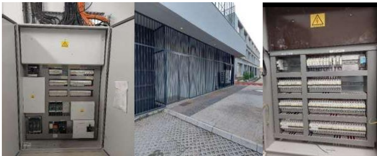
Slika br. 6a Glavna razvodna tabla
