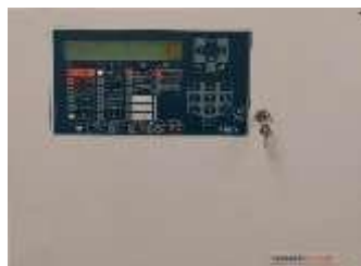
Slika br. 9a, Centralna jedinica sistema požarne automatike
