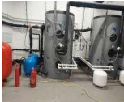
Slika br.10a Sistem pumpi i bojlera za skladištenje vode
